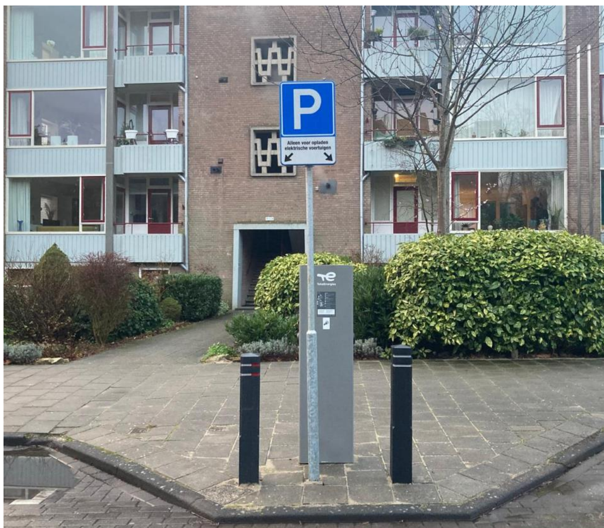
Openbare laadpaal aan de Dompvloedslaan te Overveen.
