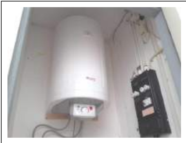
Foto 31: boiler (>1993) in gangkast van woning
