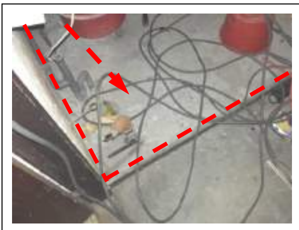
Foto 29: golfplaat (bron 5) ingestort in verhoging in cv-ruimte
