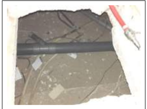
Foto 20: kunststof en metalen leidingwerk in kruipruimte
