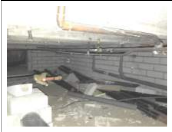
Foto 21: kunststof en metalen leidingwerk in kruipruimte
