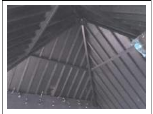
Foto 24: houten dakbeschot direct zichtbaar
