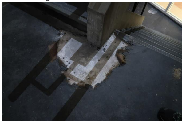
Vloerafwerking in vluchtrappenhuis beschadigd
