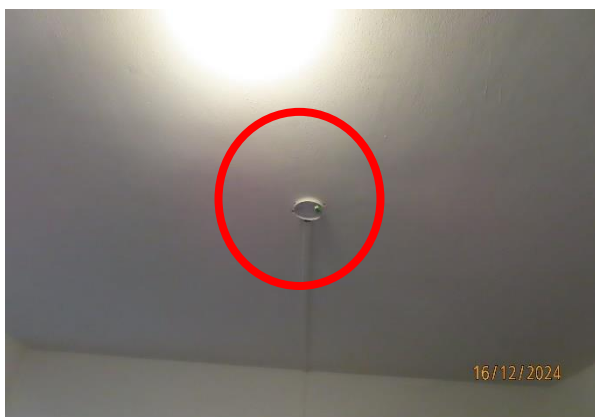
Rookmelder in kamer door bewoner verwijderd
