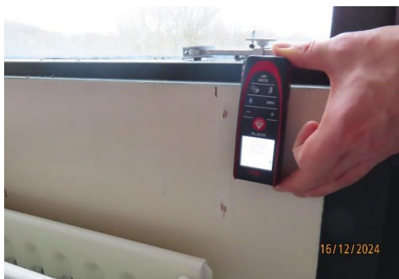
Borstwering = 0,75 mtr. Voldoet niet besluit bouwwerken leefomgeving => 0,90 mtr.
