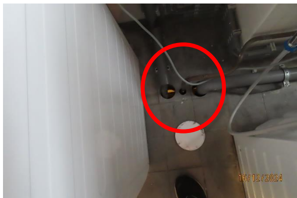
Brandwerende doorvoeringen wasruimte niet op orde
