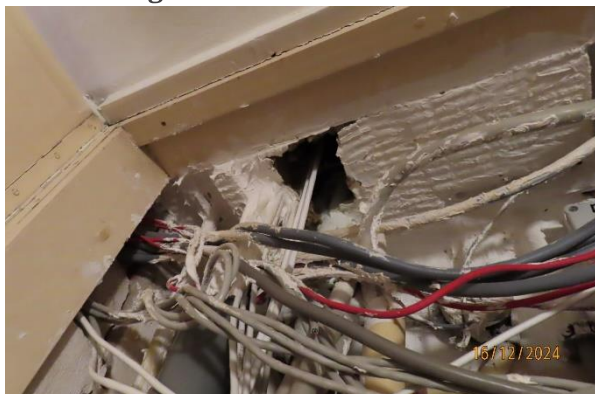
Brandwerende doorvoeringen niet op orde
