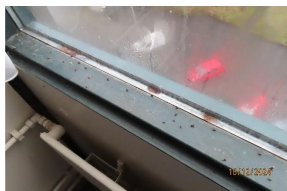
Plaatselijk lekkende beglazing geconstateerd
