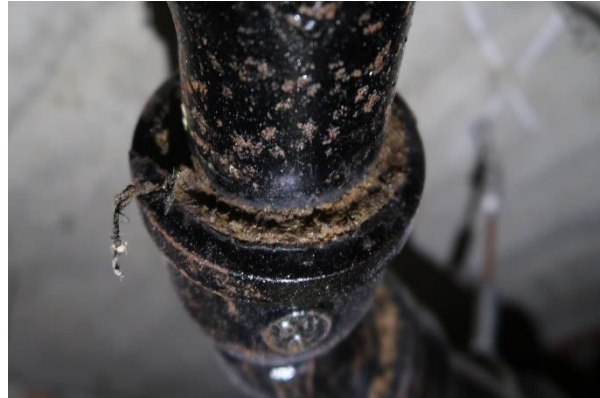
Asbesthoudende koord zichtbaar boven plafonds
