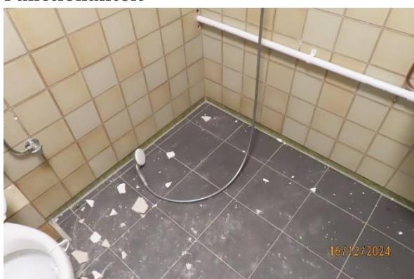
De douche bevat geen afvoer (5 e verd.)
