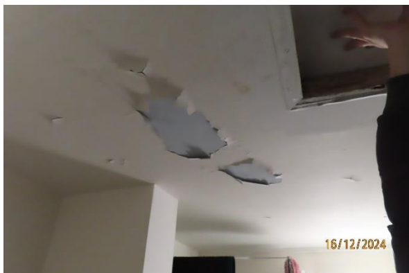
Plafond afwerking badkamer aangetast door vocht.
