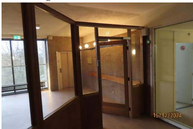
Belemmeringen in vluchtroute verwijderen
