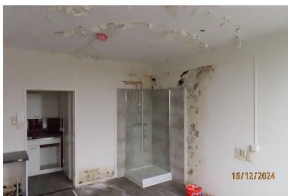
De douche is in woonkamer gesitueerd (ventilatie??)
