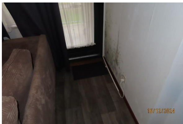
Schimmel op de wand van een woonkamer.
