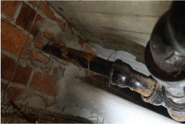
Asbesthoudende koppelstukken boven plafonds
